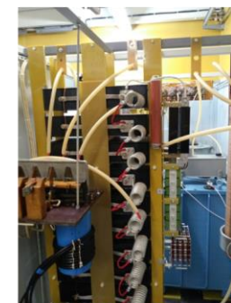
Высоковольтное оборудование источника питания
